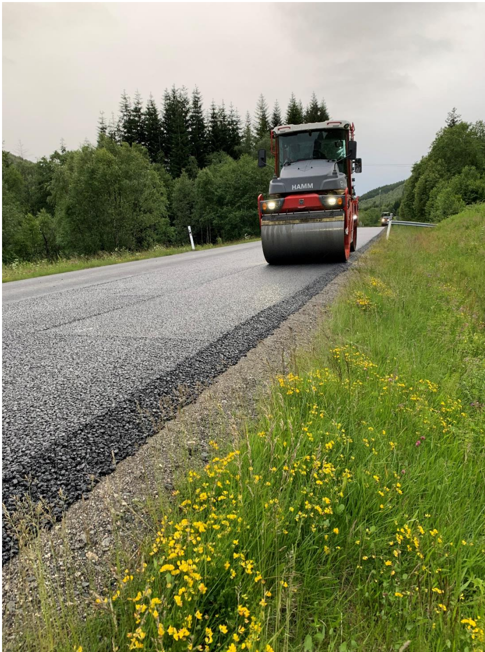
Figur 12 Homogen og fin overflate med pellets type Tv10 (Foto: Bjørn Ove Lurfald)
