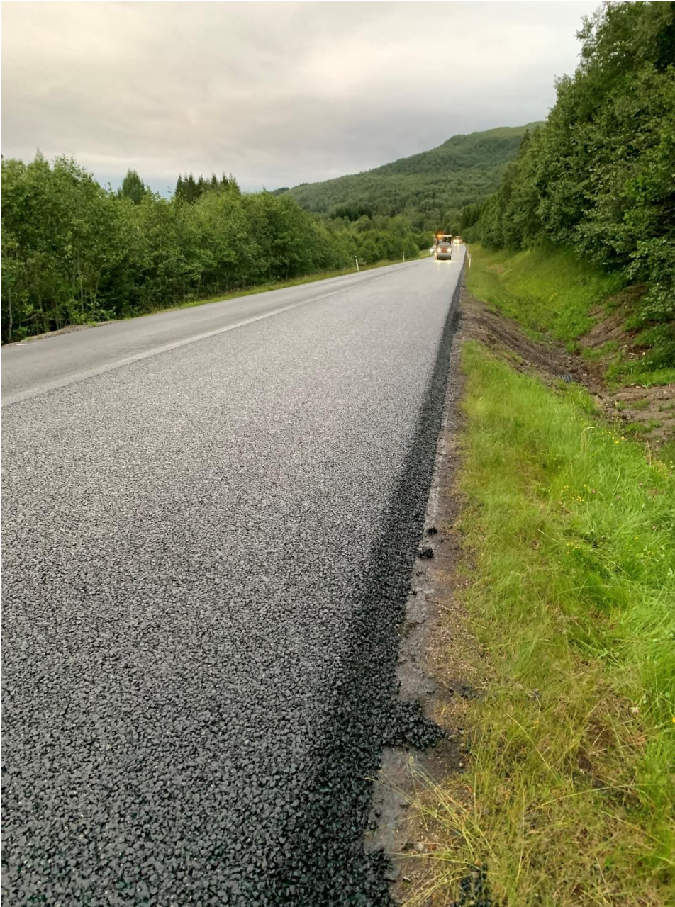
Figur 13 Homogen og fin overflate med pellets type Tv12 (Foto: Bjørn Ove Lurfald)
